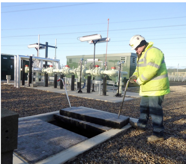
Un accès facile et sûr aux systèmes souterrains
