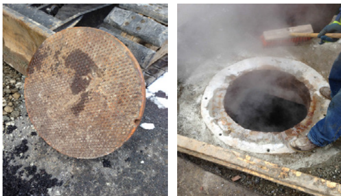
Les anciens tampons en acier étaient très lourd mais également extrêmement chauds lorsqu'ils étaient exposés à la vapeur à l'intérieur du regard.
